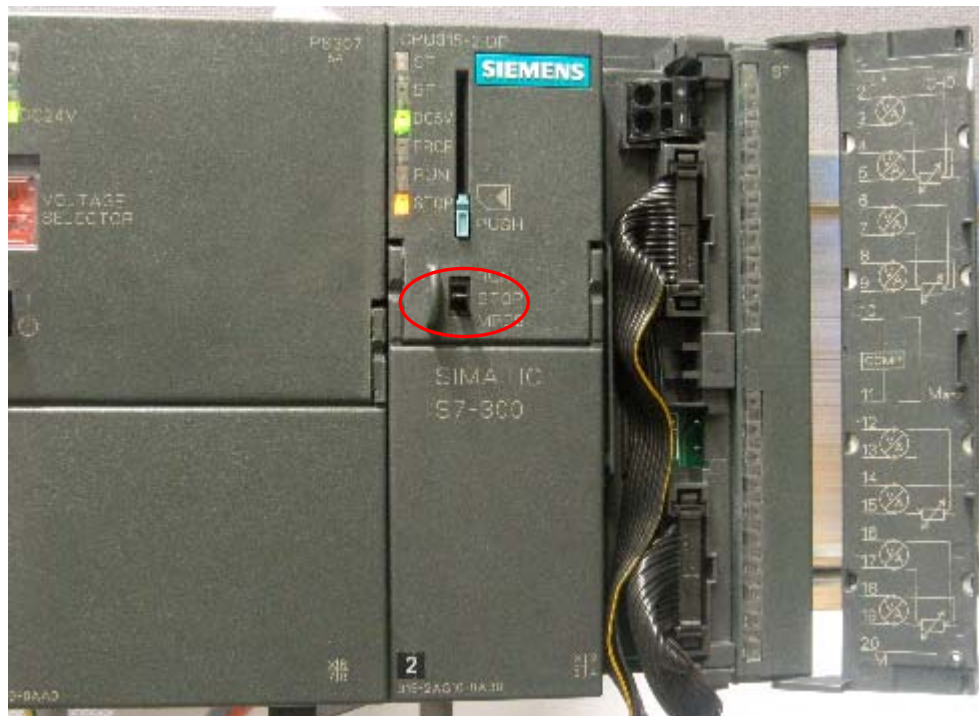
Рис. 5-1 Правильно выполненный монтаж: CPU в режиме STOP При загорании красного светодиода проверьте правильность монтажа.
